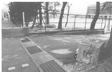
門柱が一方は北へ、他方は南へ倒れている
